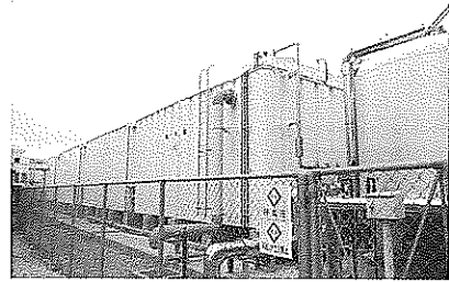
写真5 宮城県仙台市内(震度6弱) 大学病院 950m3ポンプ室付受水槽 被害なし
