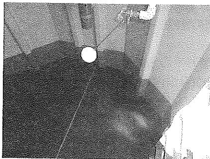
写真8 写真7の津波後の水槽内部
